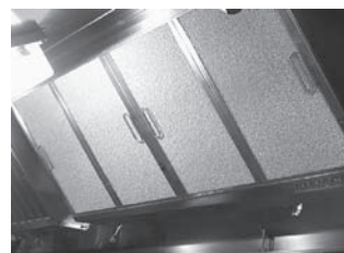
厨房設置状態
